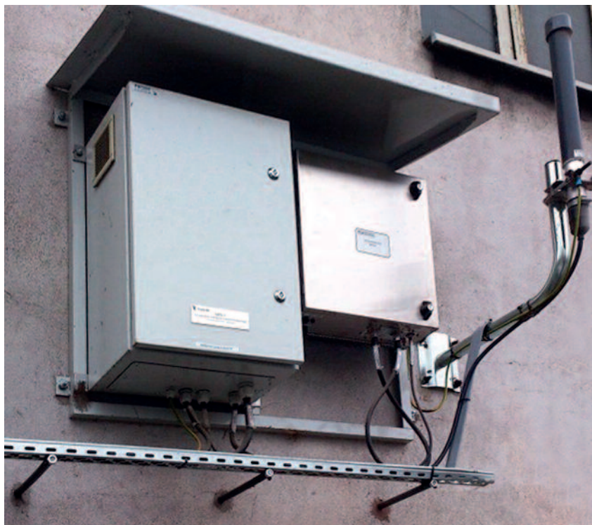
Instalacja wzmacniacza sygnalu oraz zasilania awaryjnego w jednym z tuneli
