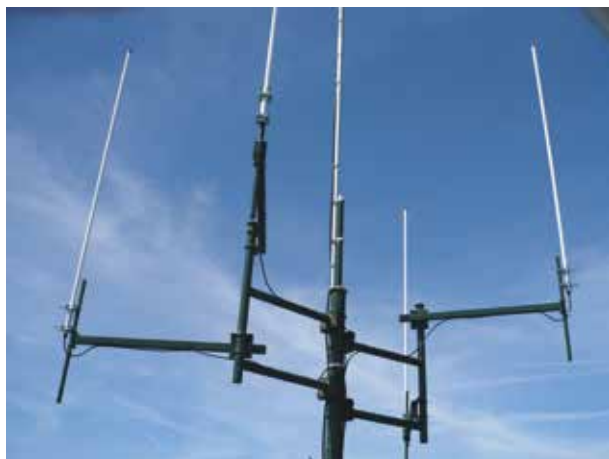
Fot. 6 Anteny 32821/4 na Posterunku Obserwacyjnym Straży Granicznej
