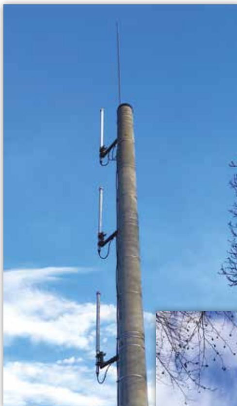
Fot. 4 Anteny 32812 zastosowane w łączności kolejowej
