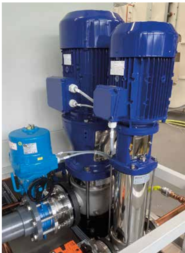
Pompy wraz z silnikami, umożliwiającymi uzyskać żądane parametry przepływu podczas prób strugoszczelności.
