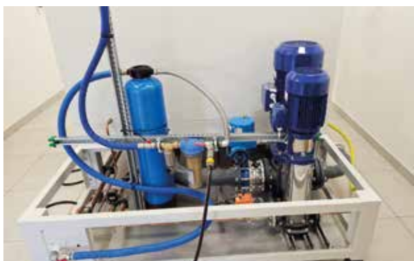
Widok komory od tyłu – układ oczyszczania i filtrowania wody.
